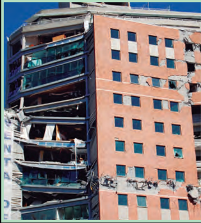
Daños en las construcciones
